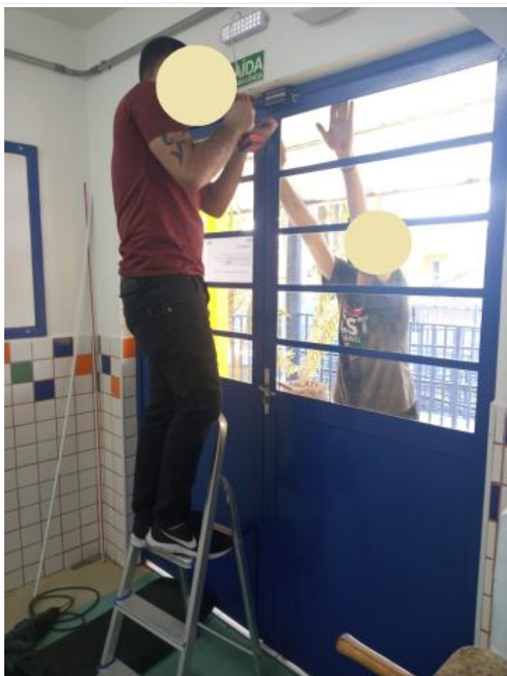
CEDIN Marilda Ferreira de Brito Pereira - Instalação do sistema magnético na porta de entrada
